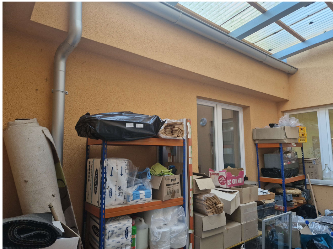
Obr. 26 – Stávající stav zastřešení a vedení dešťových svodů u venkovního atria.
